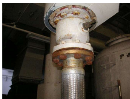
本庁舎機械室 揚水ポンプの状況
