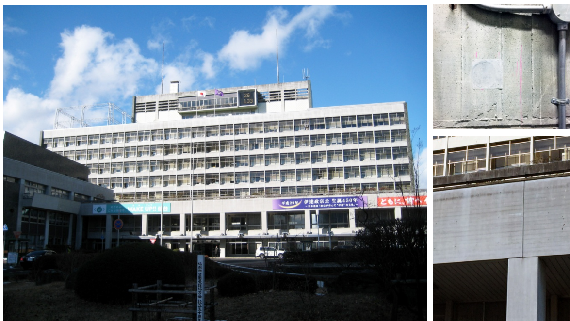
【左】本庁舎外観 【右上】中性化調査のサンプル採取跡 【右下】外壁のコンクリート打放し部分の例
