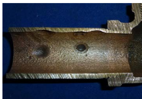
空調設備配管内部の状況
