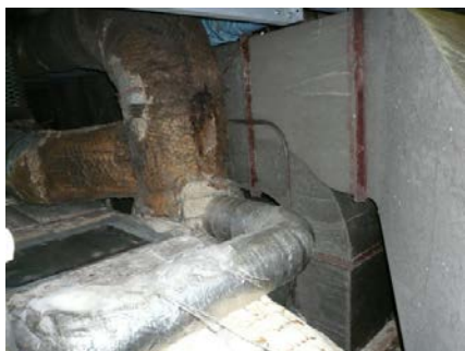
空調設備配管（劣化した保温材）
