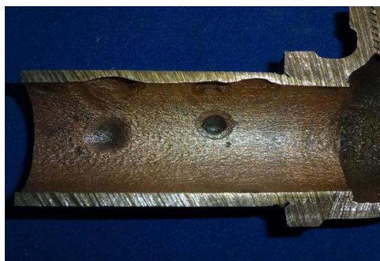
空調設備配管内部の状況
