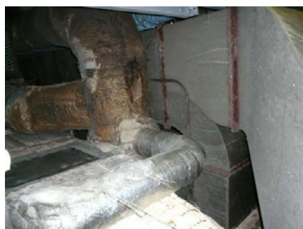
空調設備配管（劣化した保温材）
