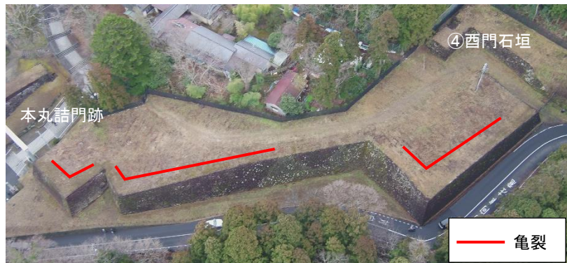
本丸北西石垣(⑤)の亀裂範囲(H27撮影に追記 北西上空から)
