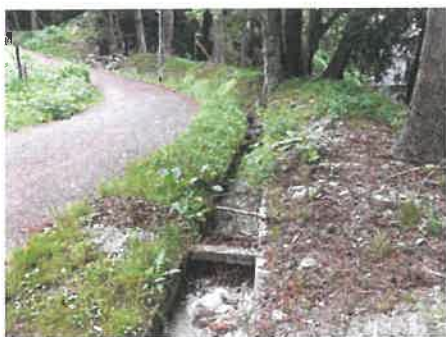
図 7-32 目詰まりしている側溝
