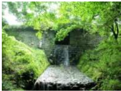
図 4-92 千貫橋の石垣①
