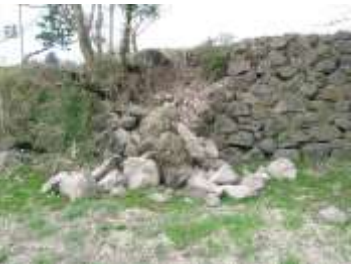
図 4-145 東日本大震災で被災した箇所④
