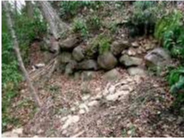
図 4-4 本丸北西下の石垣① (平成 23 年に被災)
