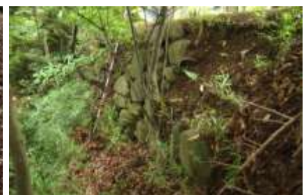
図 4-15 御守殿跡石垣⑪ (平成 23 年に被災)
