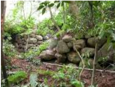
図 4-7 貯水槽石垣④ (平成 23 年に被災)
