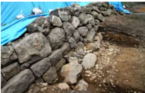
図 3-18 本丸北西石垣 石垣基部で過去の修復痕跡を確認した
