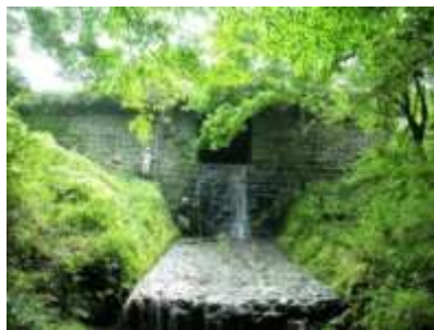
図 4-92 千貫橋の石垣①
