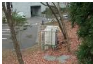
図 4-89 調査事務所給水の ための貯水槽（博物館駐 車場内）
