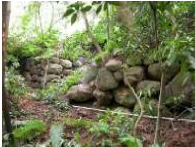
図 4-7 貯水槽石垣④ (平成 23 年に被災)
