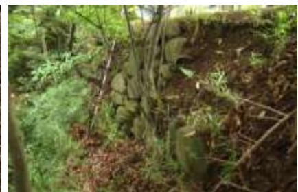
図 4-15 御守殿跡石垣⑪ (平成 23 年に被災)
