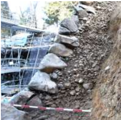
図 3-16 本丸北西石垣 野面積み背後の狭い栗石層
