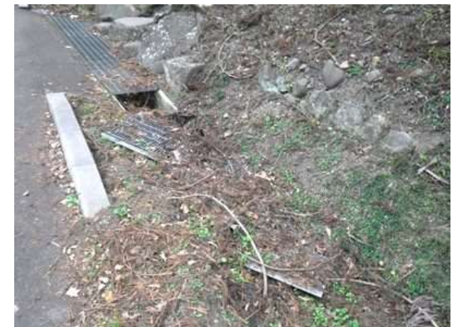
㉔清水門跡付近側溝の詰まり
