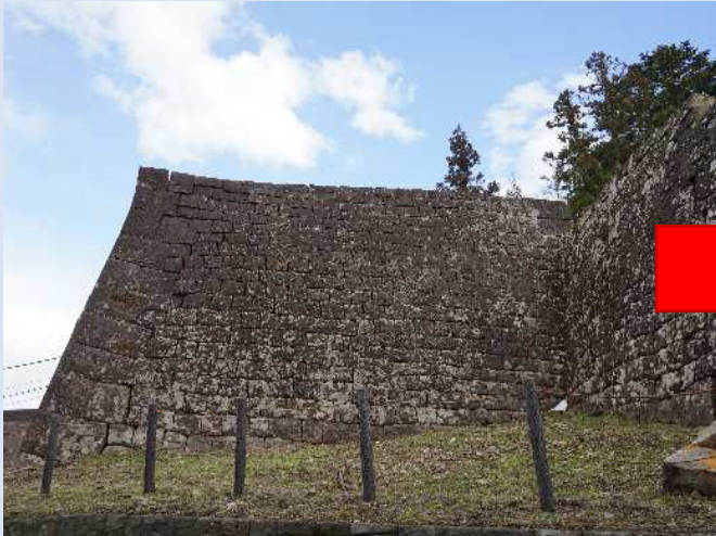
地震により変形した石垣(令和4年3月撮影)
