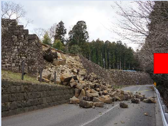
地震により崩壊した石垣(令和4年3月撮影)
