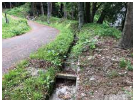
図 7-32 目詰まりしている側溝
