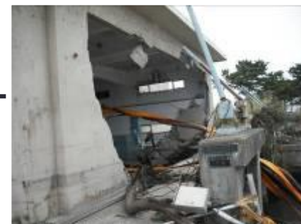
高砂南部排水機場
