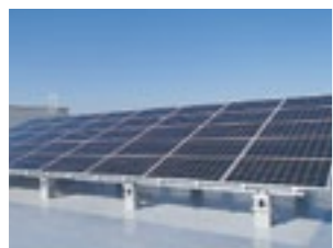
中学校屋上の太陽光発電パネル
