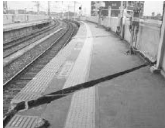
写真 仙石線苦竹駅の乗降場変状
