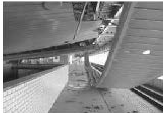
写真 天井材の落下（仙台駅ホーム） （上：復旧前、下：復旧中（80%））
