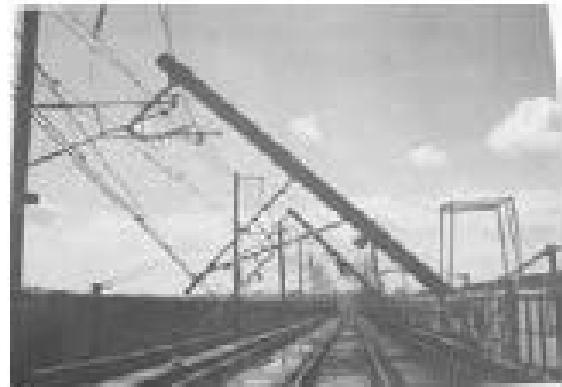
写真 電化柱の折損 (仙台～新幹線総合車両センター間) (上：復旧前、下：復旧中(55%))
