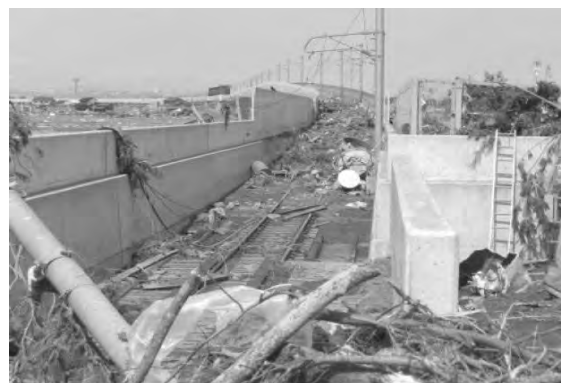
写真 仙台空港アクセス線の被害状況
