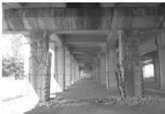
写真 高架橋柱の損傷（白石蔵王～仙台間） （上：復旧前、下：復旧後（3/25 施工完了））
