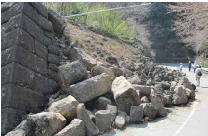
震災により崩れた仙台北城跡石垣（平成23年4月）
