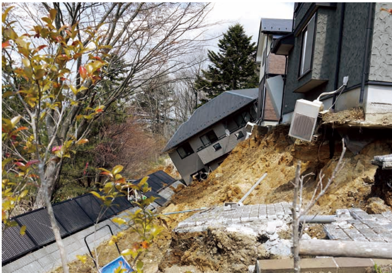
郊外丘陵部の宅地被害（青葉区西花苑）
