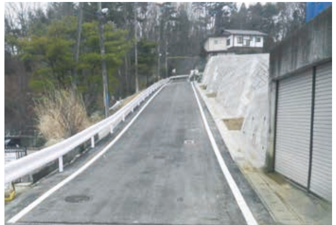
地すべり被害のあった青葉区折立五丁目地区（復旧後）（平成27年3月）
