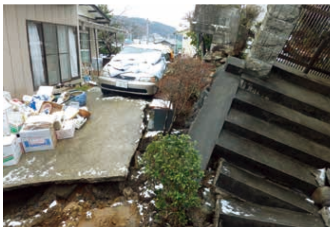
太白区青山二丁目の宅地被害
