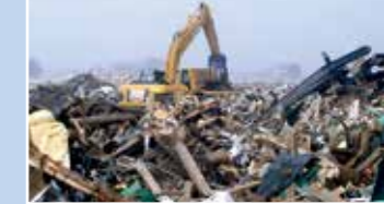
津波被害 (荒浜地区)
