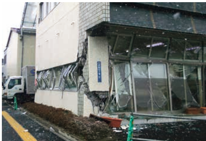
地震により損壊したビル（若林区卸町）
