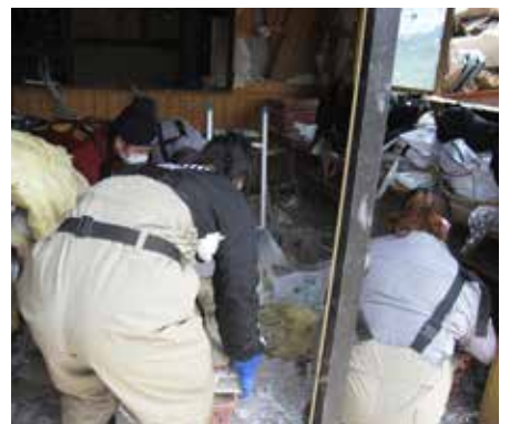
ボランティアによる津波被災家屋の片づけ
