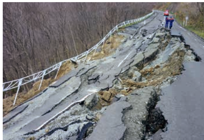
宮城野区岩切で発生した道路被害
