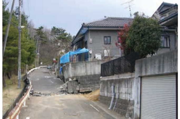
地すべり被害のあった青葉区折立五丁目地区（復旧前）（平成23年4月）
