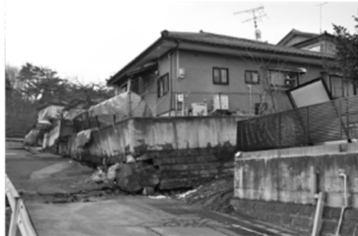
<宅地被害（青葉区折立）>
