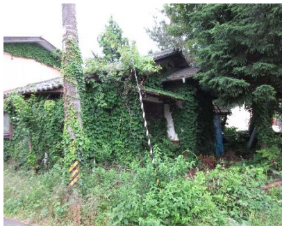
《管理不全な空家等の例》
