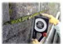
▲擁壁の傾き(写真)や水抜き穴の調査などを実施し、安全性を確認します
