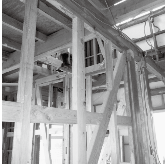
▲耐震改修工事の例。梁や筋交いを入れ、強い揺れにも耐えられるように補強します
