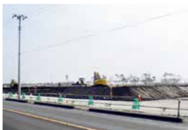
▲津波による被害を軽減するため、県道塩釜亘理線等を6メートル程度かさ上げる工事を進めています
