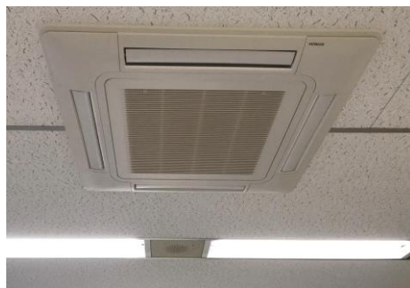
▲青葉区役所 個別エアコン
