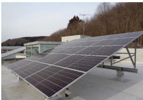
▲太陽光パネル（坪沼小跡施設）
