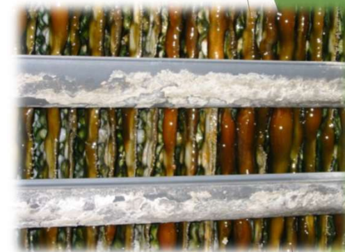
スケールが形成された 冷却塔
