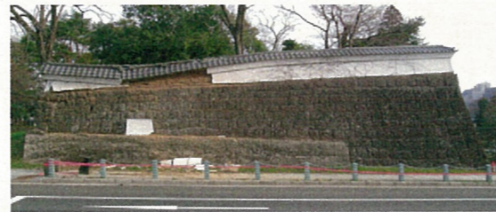
図2 土塀の被災状況
