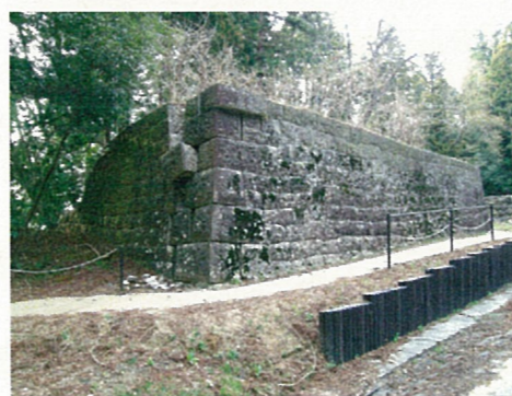
図5 中門北側石垣の被災状況
