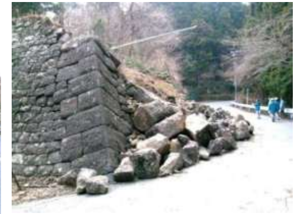
2 本丸北西石垣南部の被災状況
