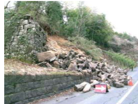
1 本丸北西石垣北部の被災状況
