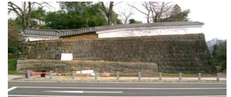
10 土塀の被災状況
