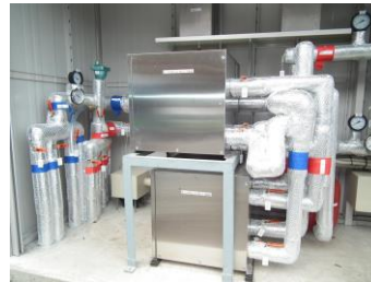
地中熱ヒートポンプ
