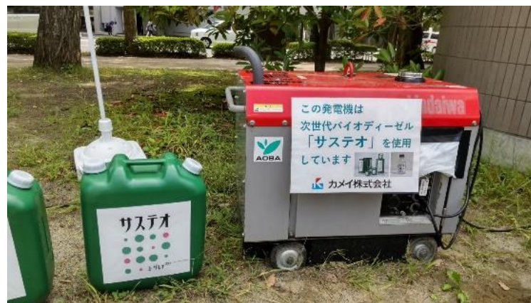
バイオマス由来の燃料を活用した発電機
