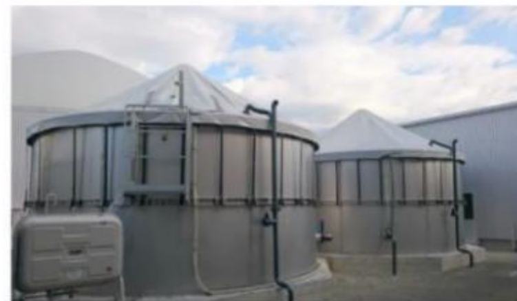
バイオガス発電 中野市
