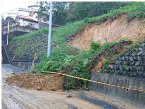
本市における土砂災害(がけ崩れ)の被害 (令和元年東日本台風)
