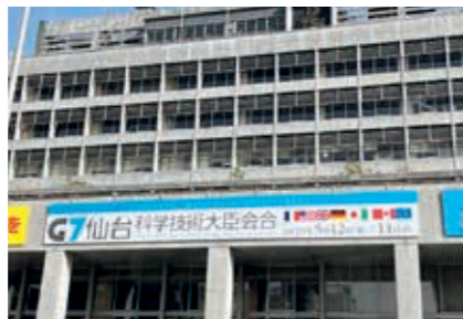
吊看板(市役所本庁舎)
