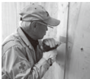
◀家屋の泥出し、床はがし、床張り、壁の付け替えなども行う岡山さん
