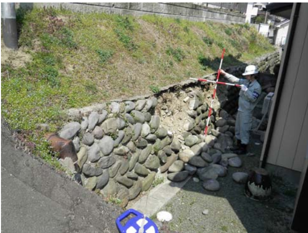
玉石積み崩落の様子
