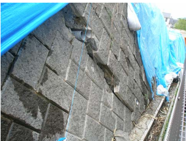
間知ブロック擁壁割れの様子
