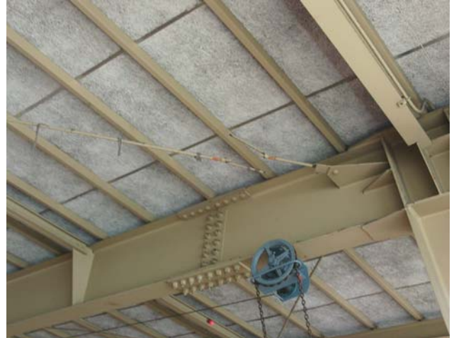
公共施設の被害状況 1 体育館の水平ブレース破断
