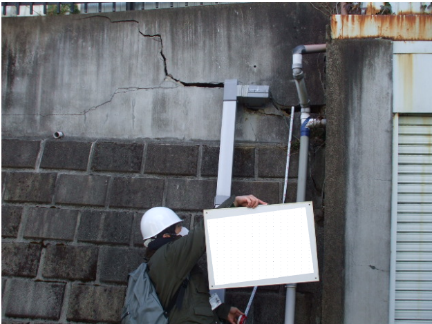
擁壁のヒビ割れの様子
