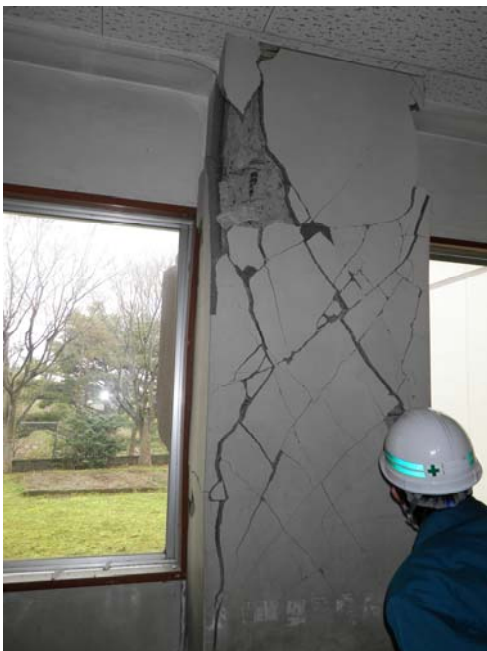
公共施設の被害状況 2 1階柱がせん断破壊
