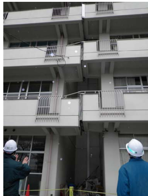
公共施設の被害状況 3 2棟ある校舎のうち1棟のみが 沈下し、EXP.J部分が破損。
