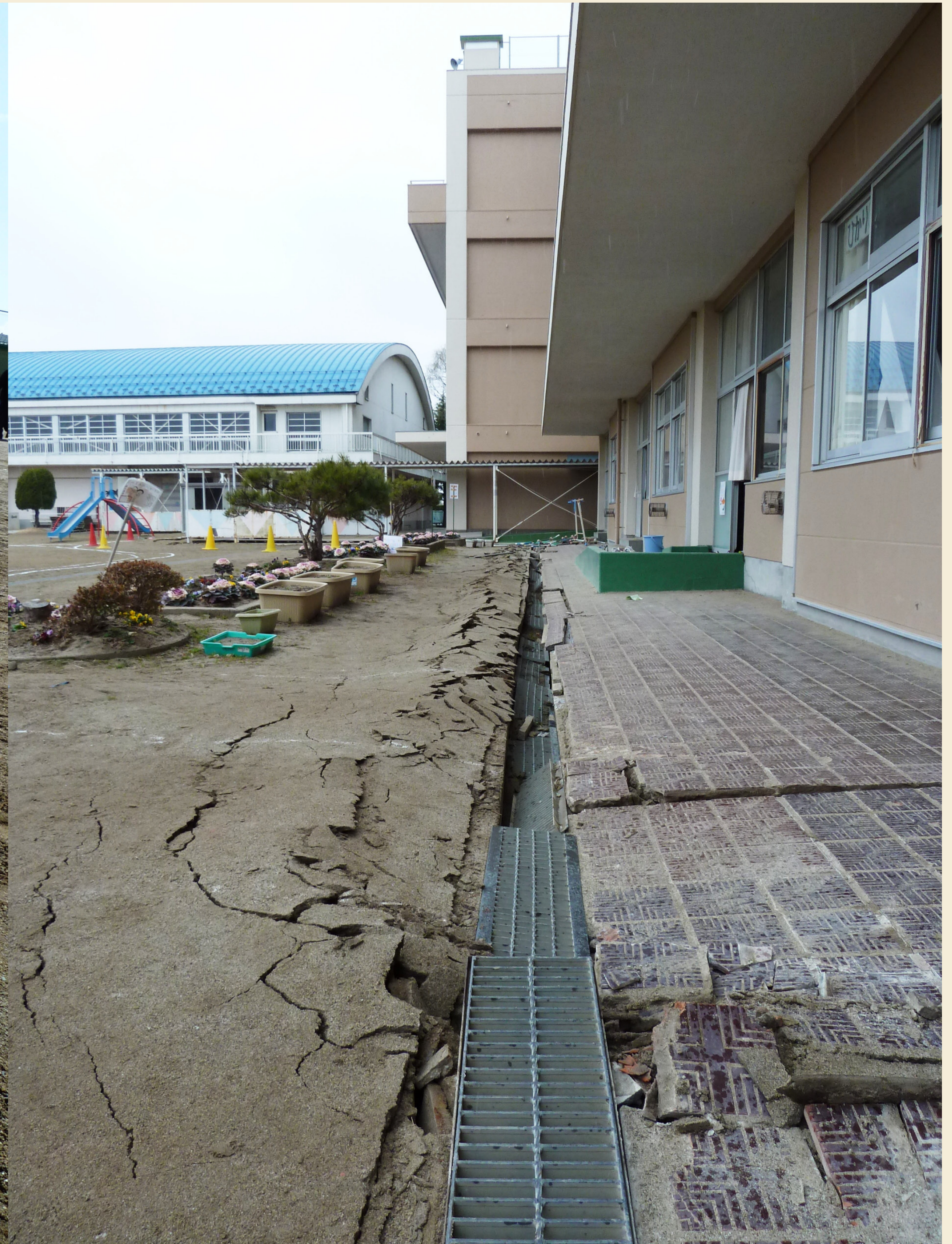
校庭の地割れと校舎前の地割れ
