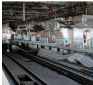
天井が落下したJR仙台駅新幹線ホーム(青葉区、2011年3月撮影)。
