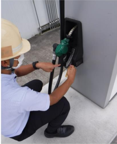
計量機ノズルの確認
