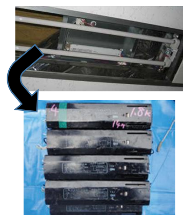
【照明器具の安定器】
