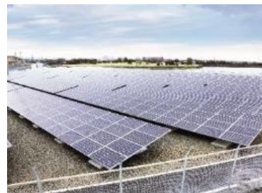
大沼太陽光発電所
