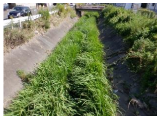
水路土砂堆積状況
