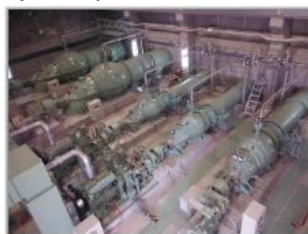
排水機場ポンプ
