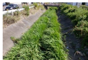
水路土砂堆積状況
