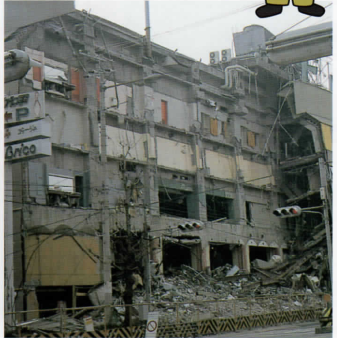
地震により外壁が崩落しています。
