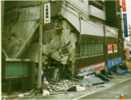
例① 倒壊した建物
