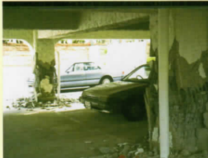
例② 建物の甚大な被害
