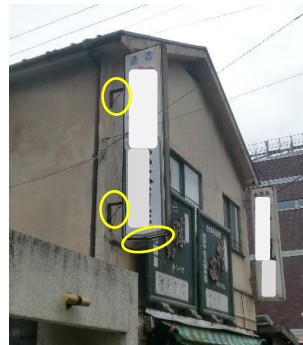
腐食による全体的な劣化など
