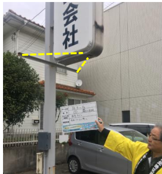
振れ止め設置不良
