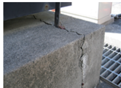
看板基礎のひび割れ
