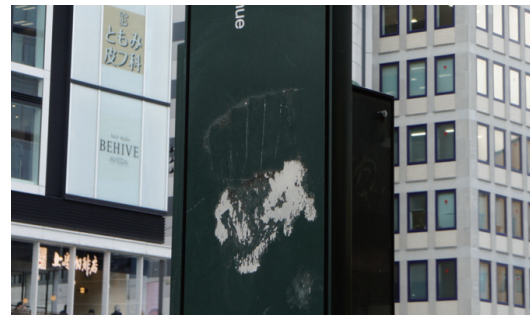
塗装の剥がれ
