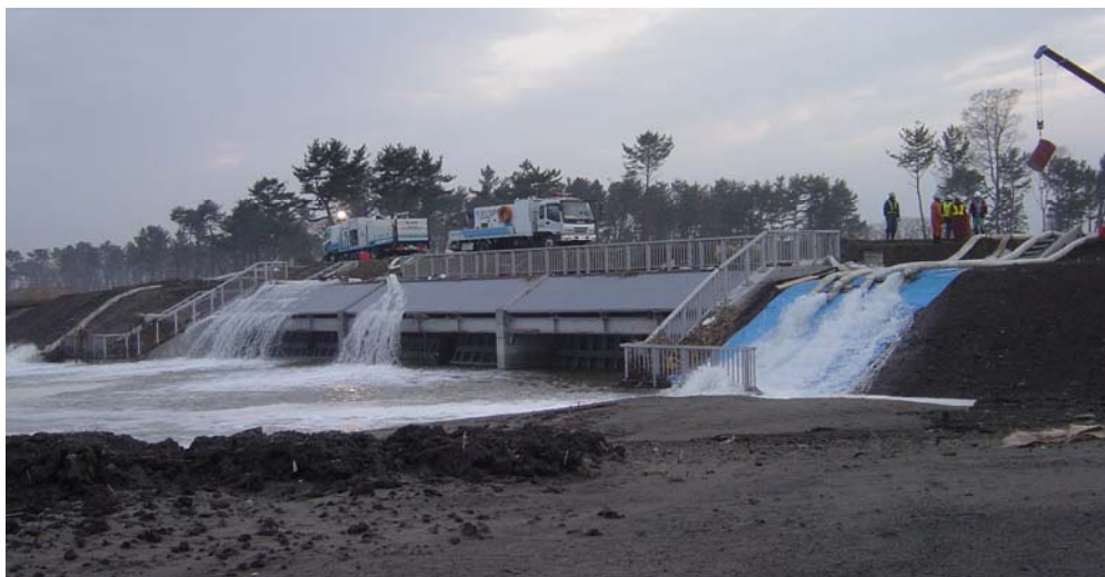
井土浦排水樋門(仙台市若林区藤塚)における排水作業状況
