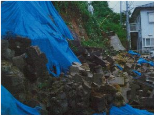
宮城野区東仙台：人家裏の法面崩壊
