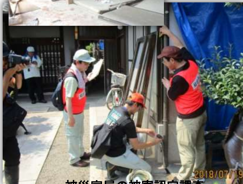
被災家屋の被害認定調査
