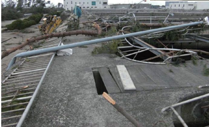
津波の圧力で横倒しになった手摺や照明 (曝気槽上部)
