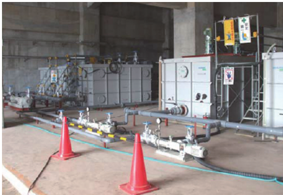
既設の遠心脱水機が運転開始（平成23年5月）
