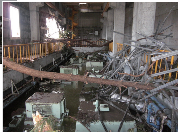
送風機室内部 (ブローア本体が水没)
