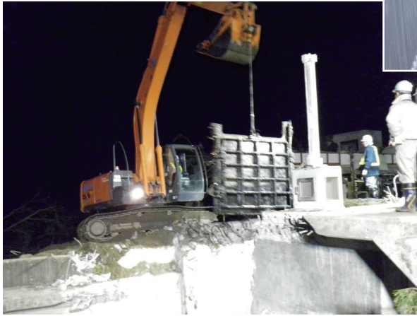
緊急放流量を確保するため、 開閉不能となった緊急放流ゲートを撤去
