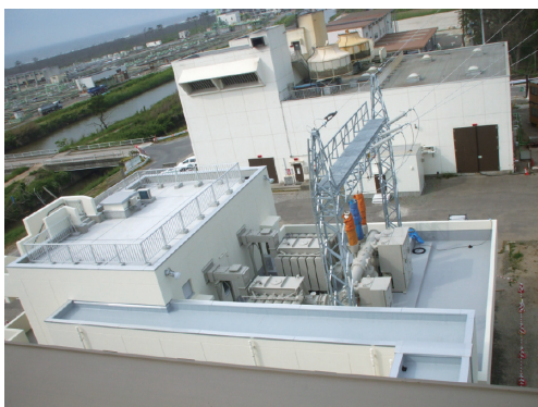
平成24年6月 特別高圧受電棟が完成し、高圧受電(6,600V)から特別高圧受電(66,000V)に切り替え
