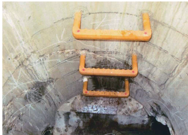
マンホール内クラック（宮城野区岩切地区）
