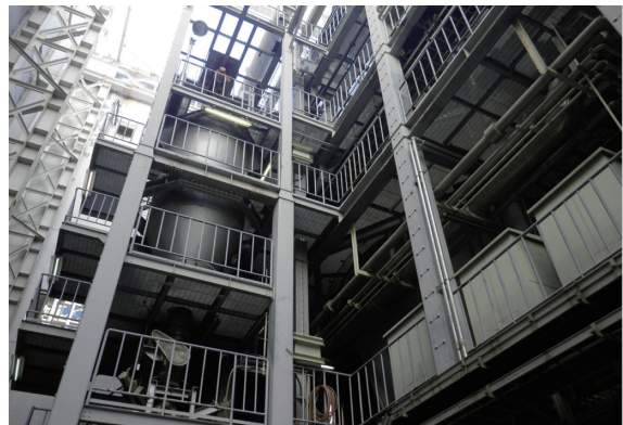
1号焼却炉運転開始（平成24年3月）
