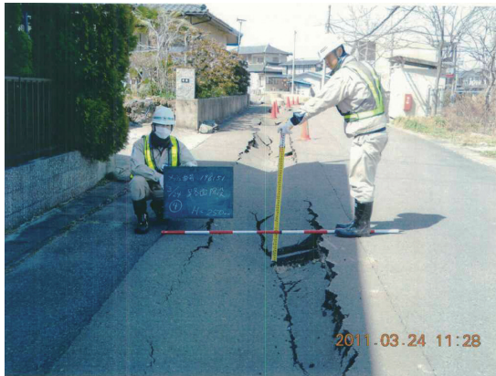
管路部分道路陥没（泉区松森地区）
