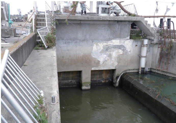
開閉不能となった緊急放流ゲート
