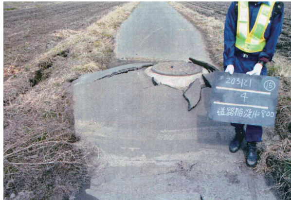
液状化によるマンホール隆起（若林区霞目地区）
