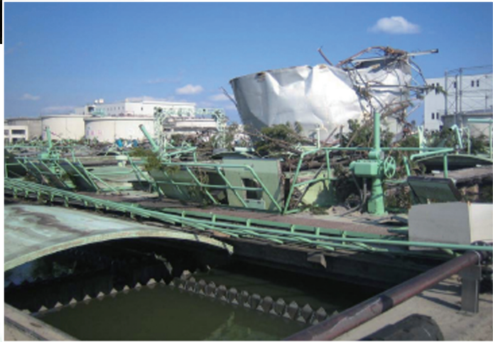
ガスタンク上蓋が津波により流失 (最初沈殿池上部)
