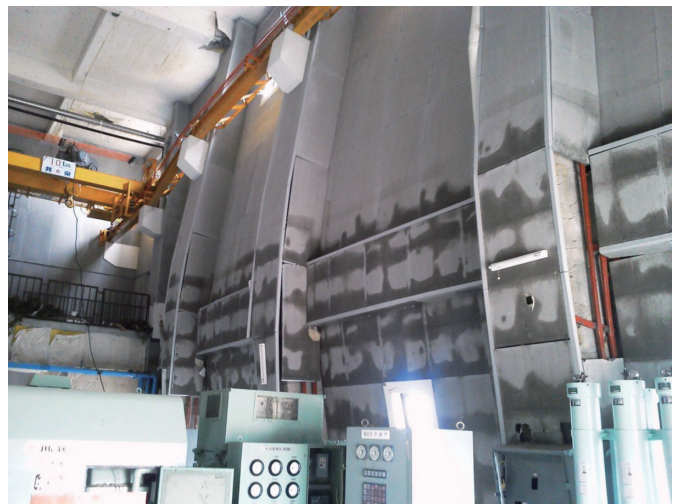
第3ポンプ室内部 (津波の圧力によりコンクリート柱が湾曲)
