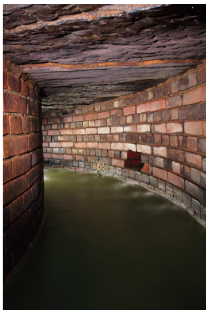
矩形渠：片平丁幹線 明治33年5月竣工 敷設場所：片平丁小学校付近
