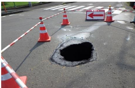
管路の破損により陥没した道路
